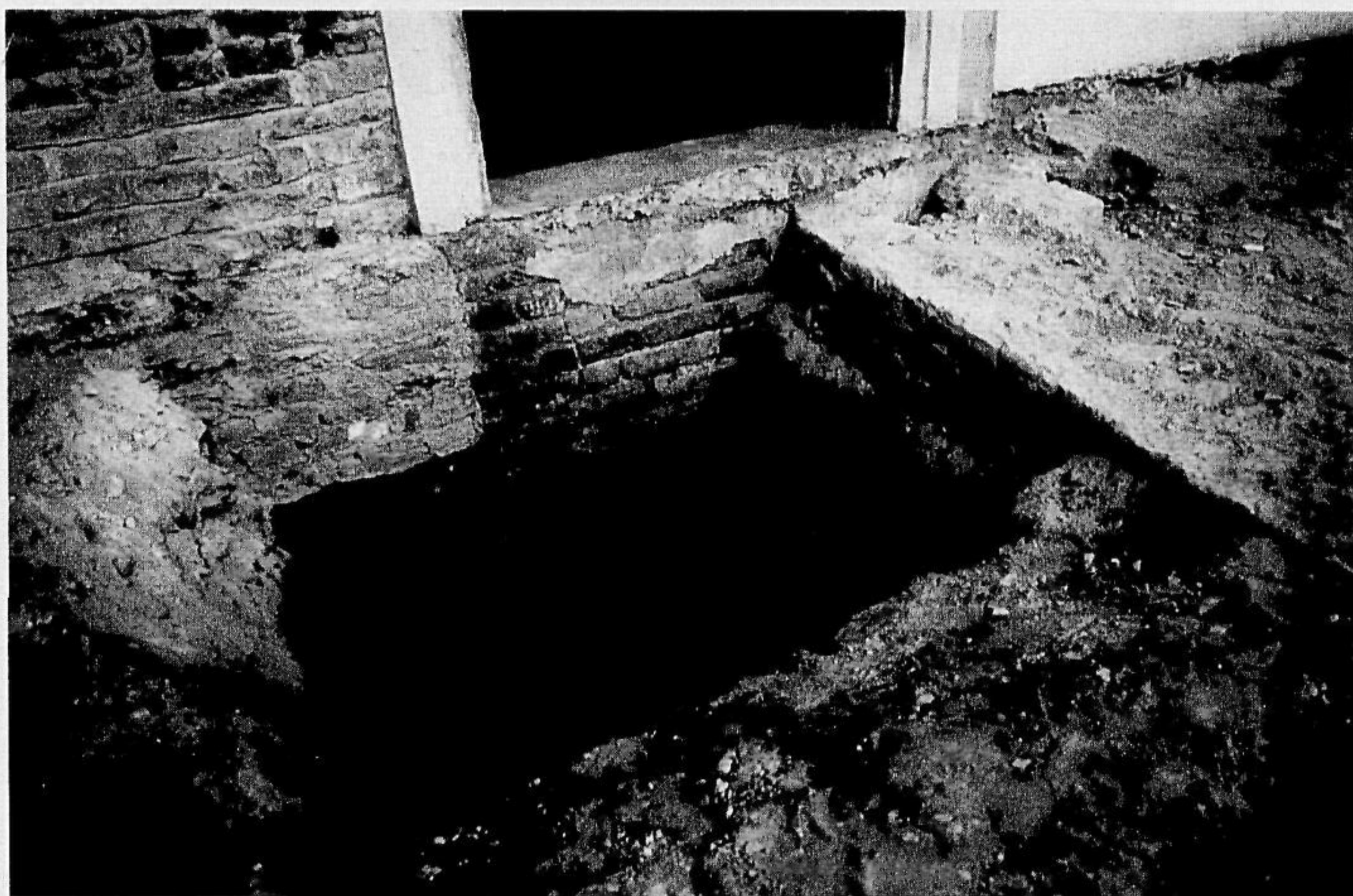
Fig. 8f - Particolare del muro transetto destro: si vedono mattoni con fughe regolari e tracce d'intonaco.
