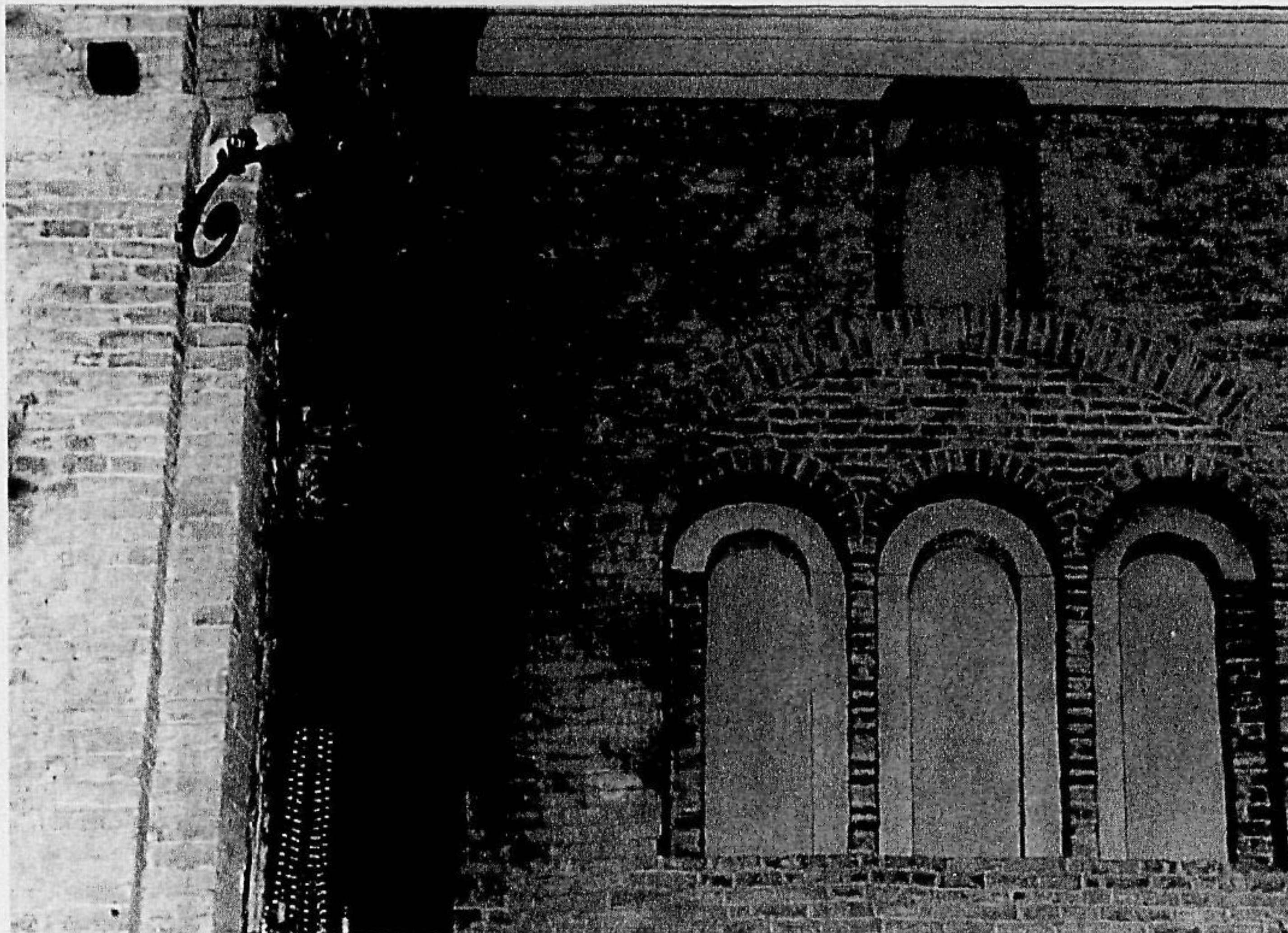
Fig. 11a - Parete d'angolo abside-transetto destro: sono evidenti i tiranti in legno e la cornice niellata.
